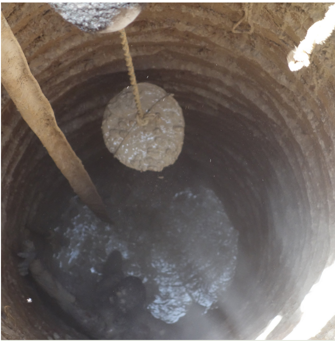
Creusage et construction manuelle d'un puit pour l'irrigation des légumes. (Stefan Graf)
