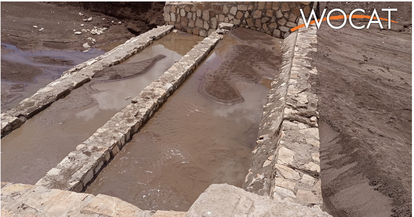
Barrage de rétention d'eau en béton maçonné à double bassin où des quantités massives de sédiments sont piégées par l'ouvrage. (Gerba Leta)
