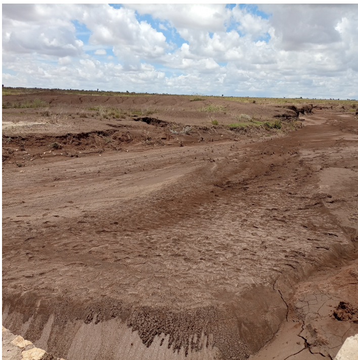
D'énormes quantités de sédiments et débris portées par les eaux ont été piégés derrière l'ouvrage récemment construit. (Gerba Leta)
