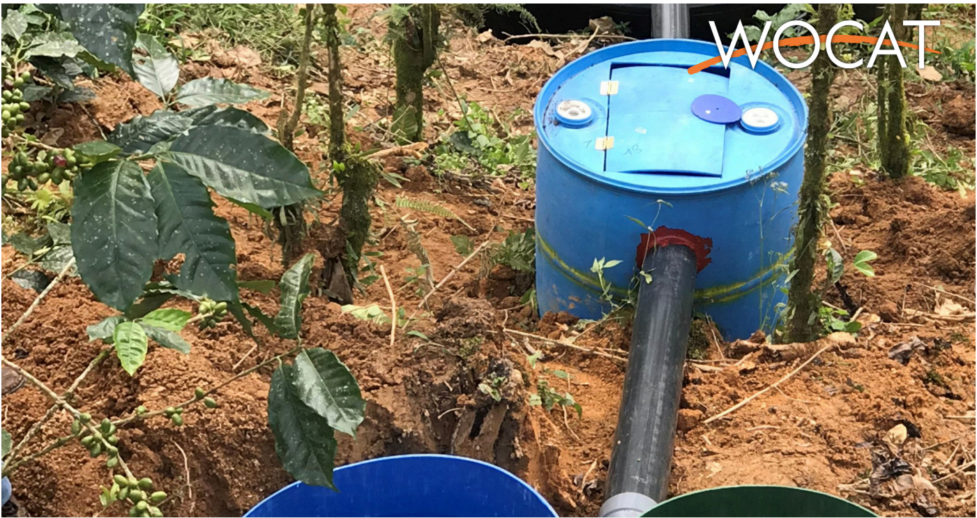
Sistema de Tratamiento de aguas mieles (STAM) en fincas de productores de café de la cuenca del Río Dipilto. (Carlos Ramón Marín)
