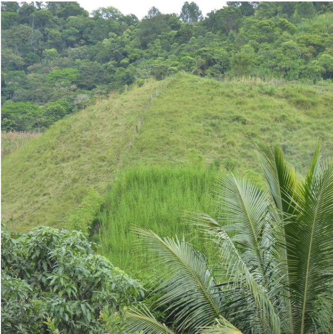
Despues de su implementación, las fajinas de drenaje ya no son visibles. En este caso están cubiertos con pasto Maralfalfa que sirve como forraje para el ganado. (Helen Gambon, Cruz Roja Suiza)
